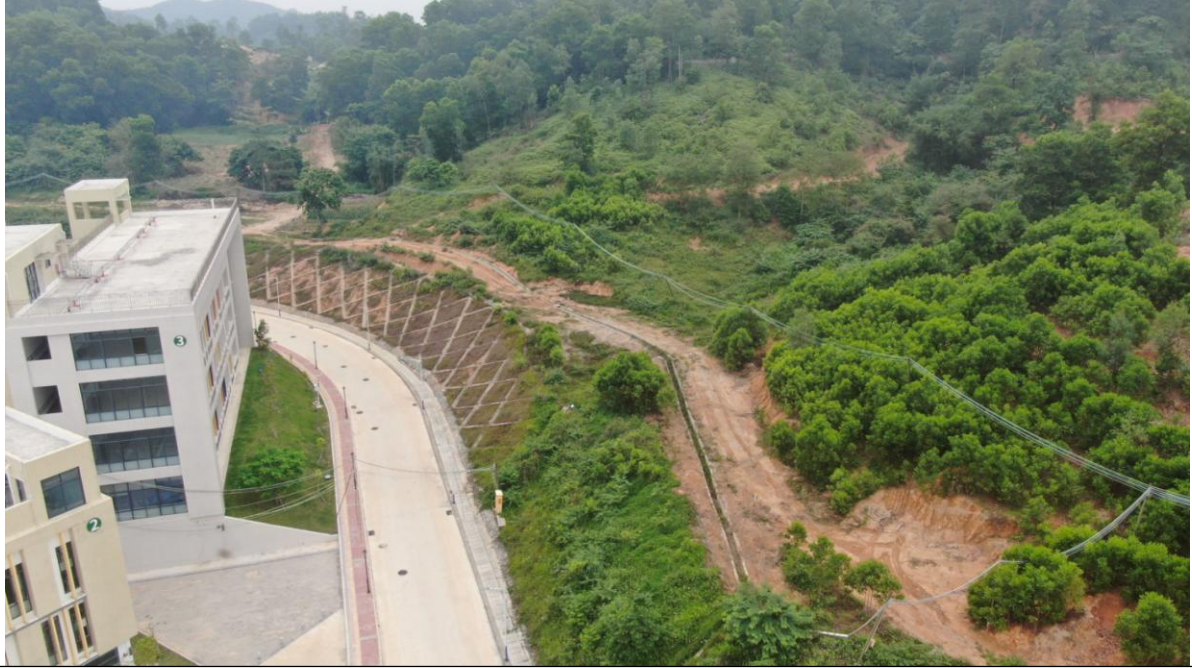
位 置：环校路 K0+730~K0+820 现场情况：边坡落实骨架植草护坡、截水沟、急流槽等措施。
